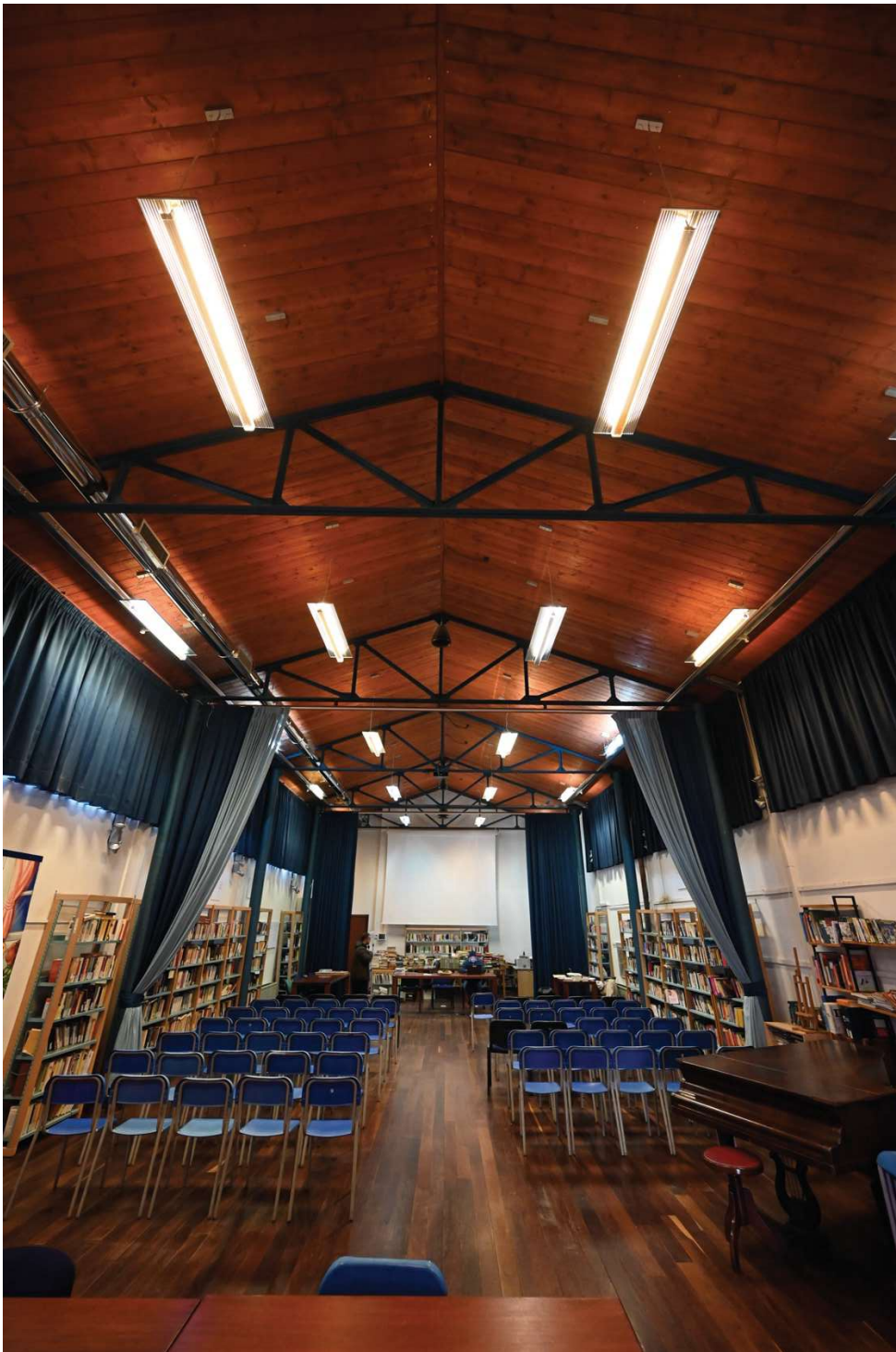
Biblioteca, corpi illuminanti dei quali si prevede la sostituzione
