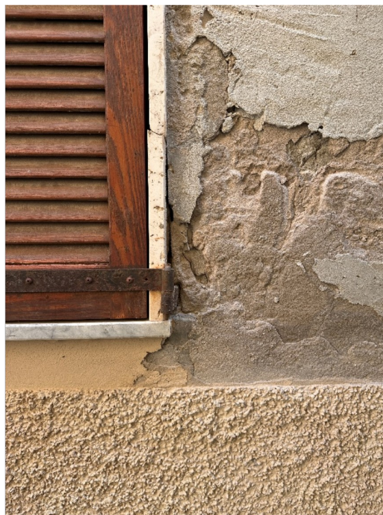
Fig. 32 – Dettaglio degrado muratura
