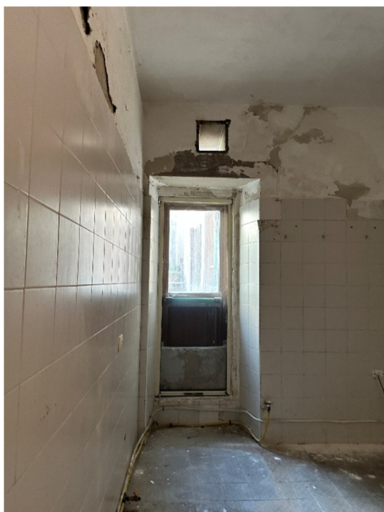
Fig. 34 – degrado servizi igienici P.1 Corpo A
