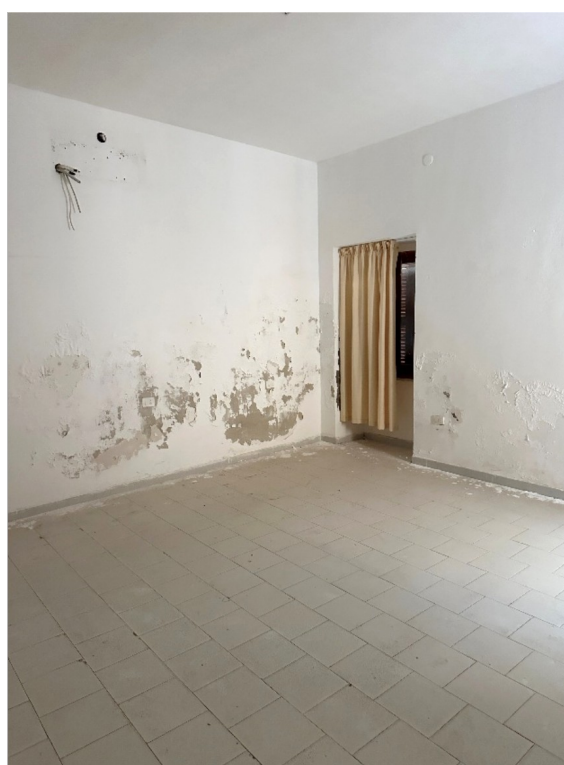
Fig. 33 – degrado murature P.T. Corpo A
