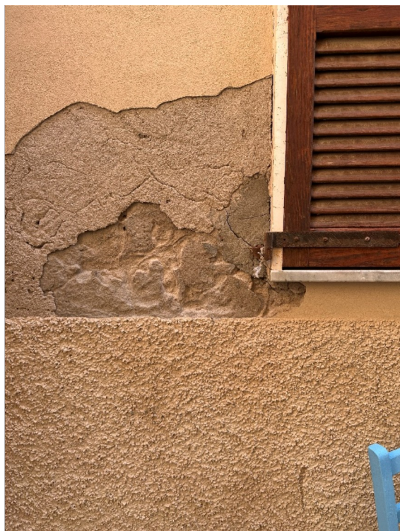
Fig. 31 – Dettaglio degrado muratura facciata
