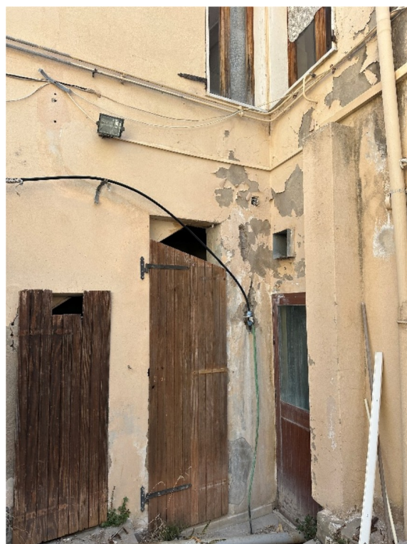
Fig. 37 – degrado facciata interna
