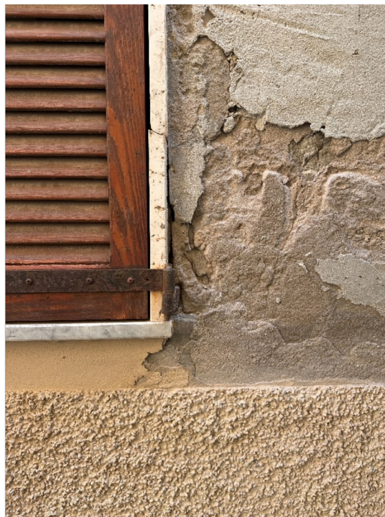
Fig. 32 – Dettaglio degrado muratura
