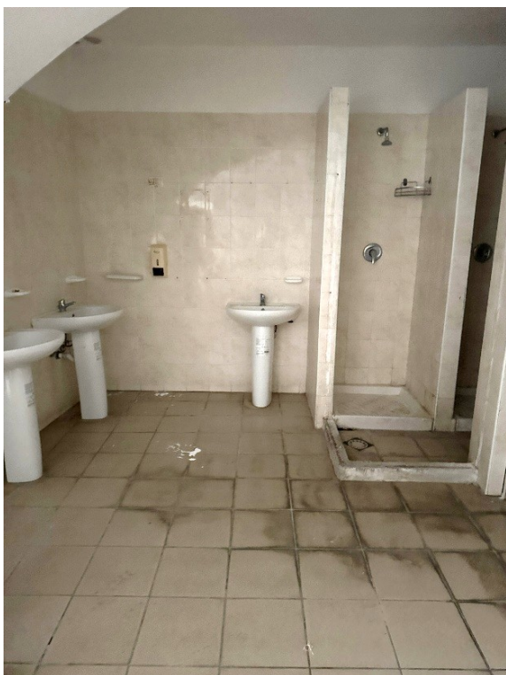
Fig. 32 – degrado servizi igienici P.T. Corpo A
