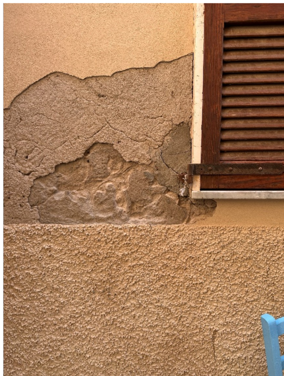
Fig. 31 – Dettaglio degrado muratura facciata
