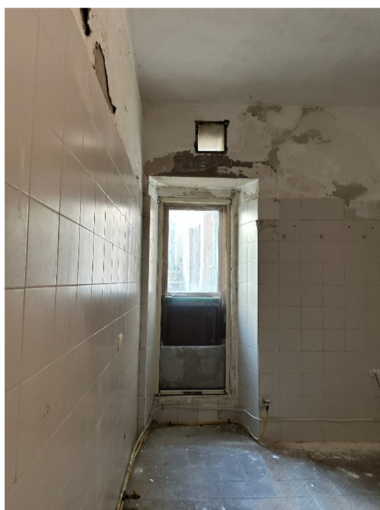
Fig. 34 – degrado servizi igienici P.1 Corpo A
