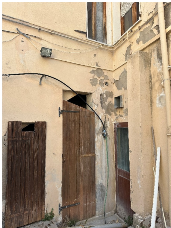
Fig. 37 – degrado facciata interna
