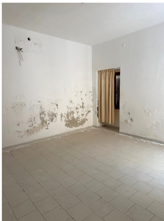
Fig. 33 – degrado murature P.T. Corpo A
