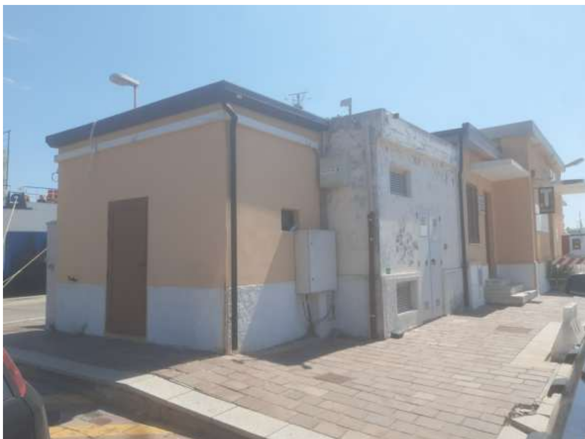
Foto 2 – Cabina MT – prospetto Sud
