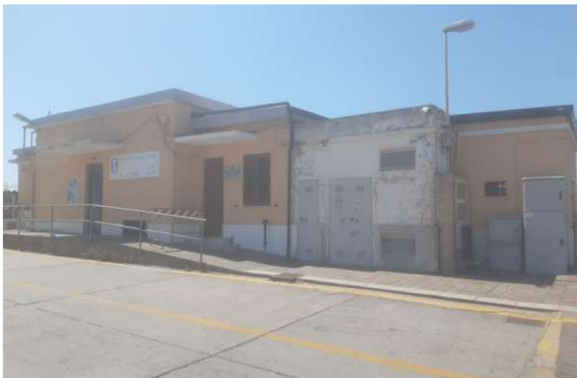
Foto 1 – Cabina MT – prospetto Nord
